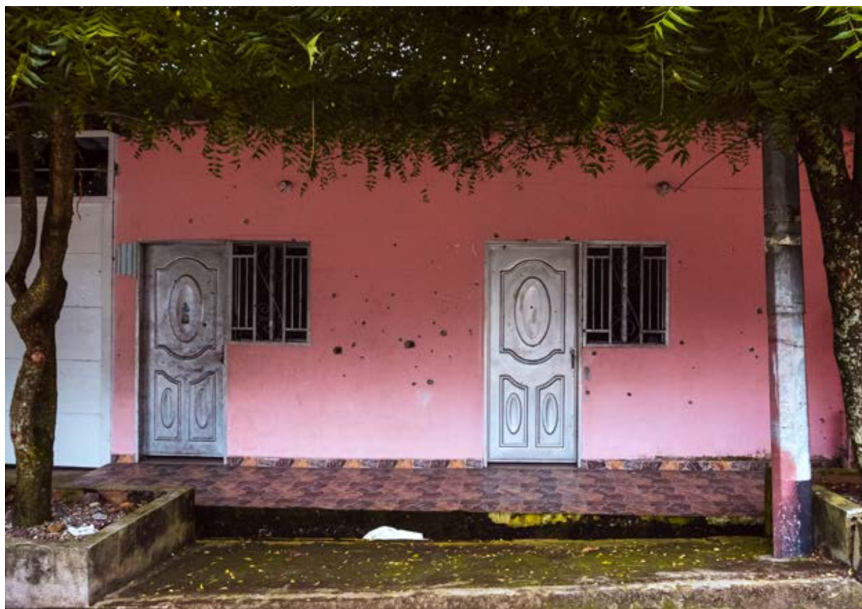
Foto 15. Vivienda afectada por drones
